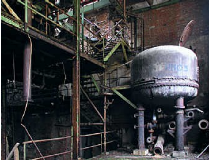
pulverm-innen4: ein alter Kessel mit diversen Rohrenden, marode Stahlkonstruktionen einer Zwischenetage, die wackeln, wenn man gegen die Stützen tritt und ein Abgrund in den Keller
