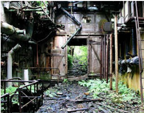
pulverm-innen3: frisches Tageslicht von oben, wegen teils eingestürztem Dach, Bewuchs, Treppen in den Keller und Vegetation innen und außen, sowie ein beißender Geruch, den man leider nicht mit fotografieren konnte.
